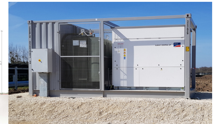
Photographie 46. Poste de transformation
